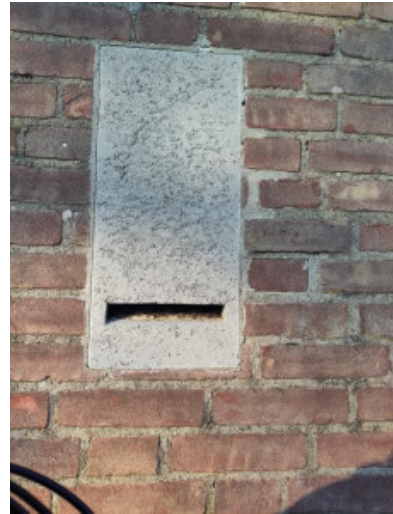
Vleermuiskast. Dwergvleermuis uitwerpselen aangetroffen.
