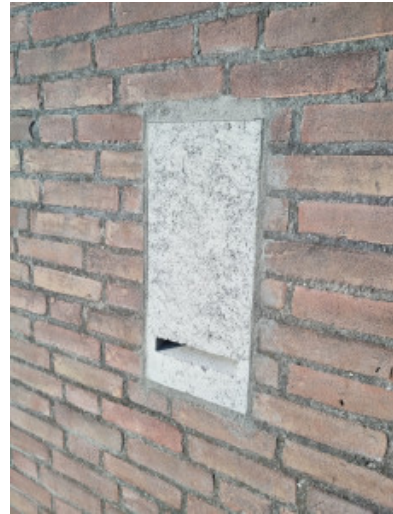
Vleermuiskast. Geen sporen aanwezig.
