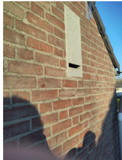
Vleermuiskast. Uitwerpselen dwergvleermuis aangetroffen.
