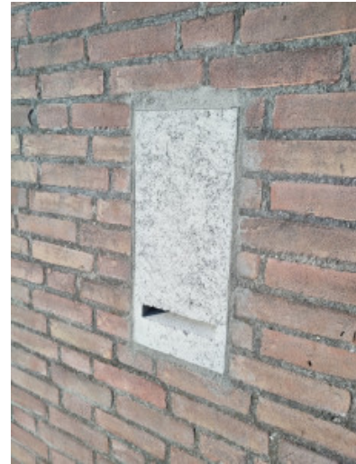
Vleermuiskast. Geen sporen aanwezig.
